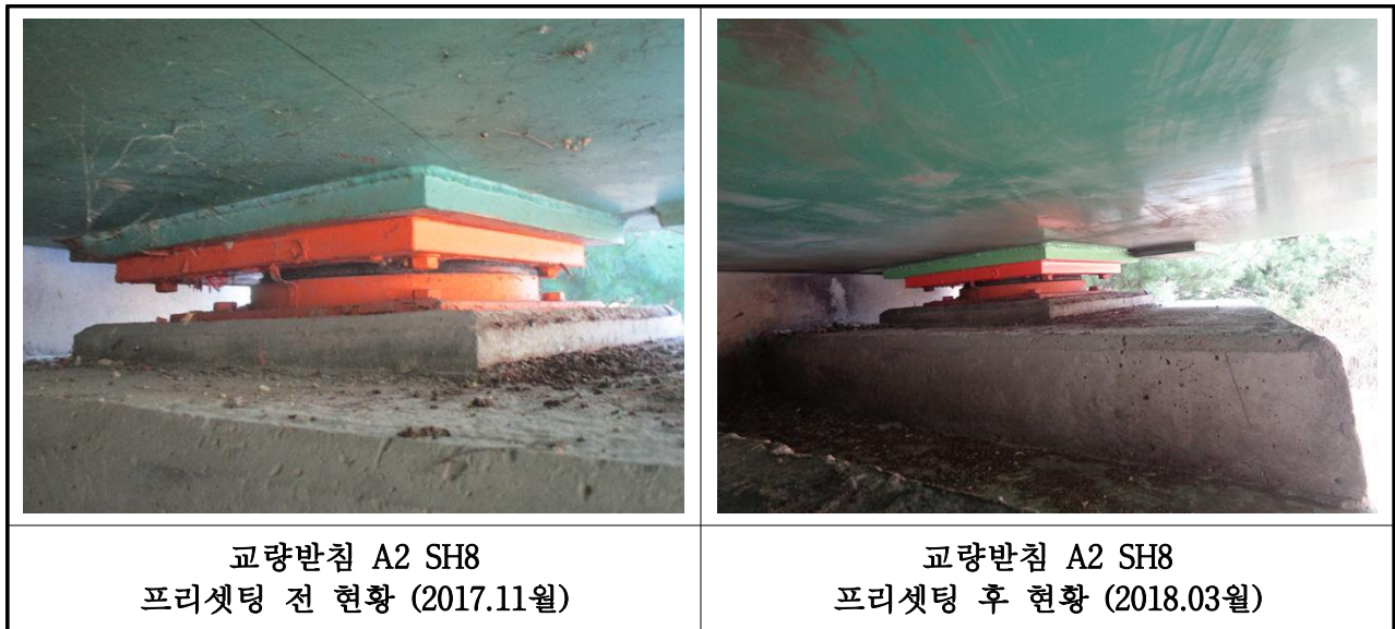
【사진 3.32】 교량받침 손상현황(계속)
