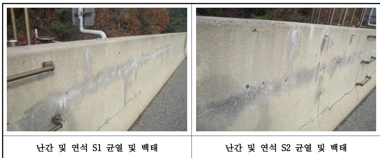
【사진 3.41】 난간 및 연석 손상현황
